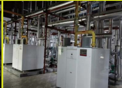
改造後天然氣熱水鍋爐
