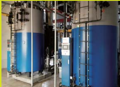
改造後天然氣蒸汽鍋爐
