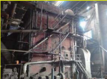
改造前的燃煤鍋爐
