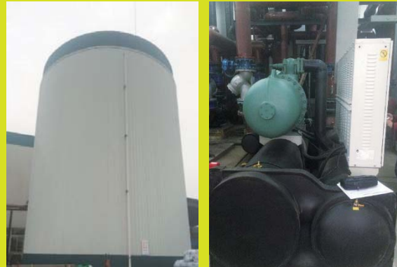
水蓄冷罐餘熱回收機組及管網
